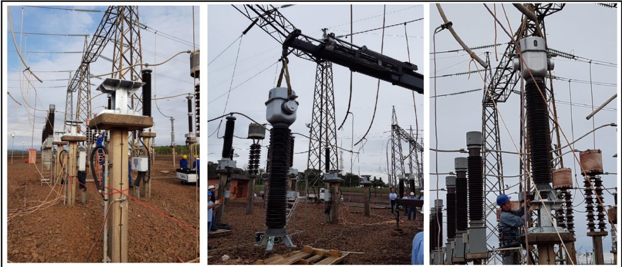
Figura 3: Trabajos de montaje de TC de medición de facturación en la SEMD.
